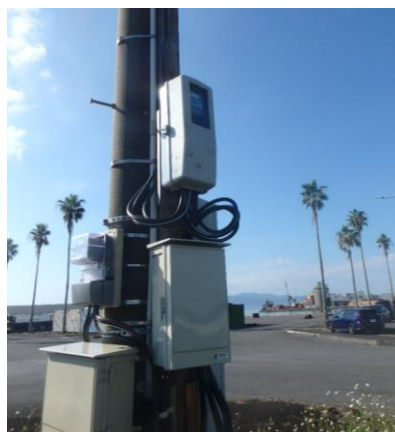
陸上電力供給設備(分電盤)
